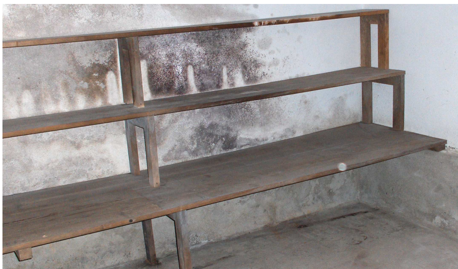
Bild sanosil ag Kapillar – eindringende Feuchtigkeit und ungenügender Luftwechsel.
